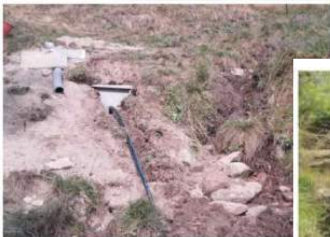
PUNTO DI PRELIEVO E POZZETTO DI DERIVAZIONE
