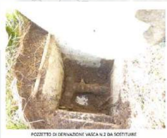
POZZETTO DI DERIVAZIONE VASCA N.2 DA SOSTITUIRE
