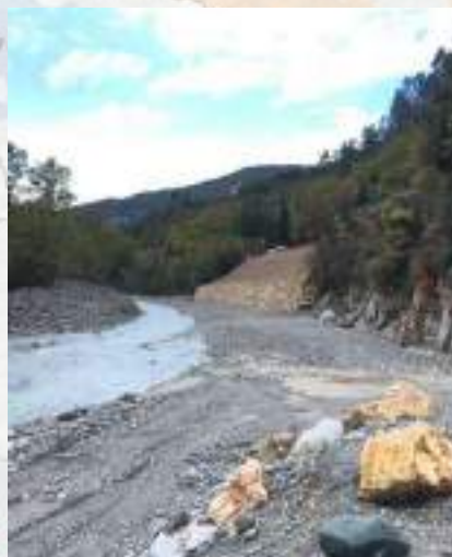
Photographies de l'état des lieux
